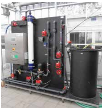
Watertechnologieën zoals deze ultrafiltratie membraaninstallatie voor de voorbehandeling van ruw water, zorgen voor waterhergebruik dat de veerkracht van deltaregio's verhoogt.
